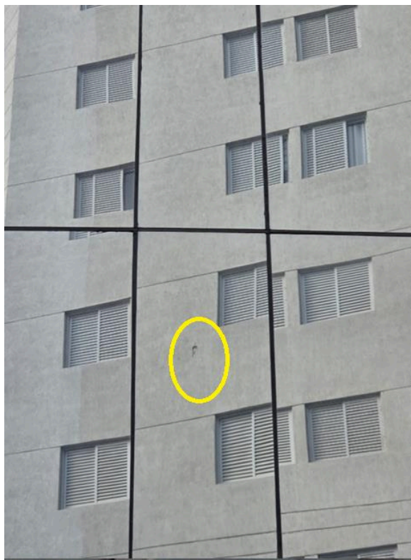
Figura 15 – Imagem ilustrativa destacando vidro quebrado.
