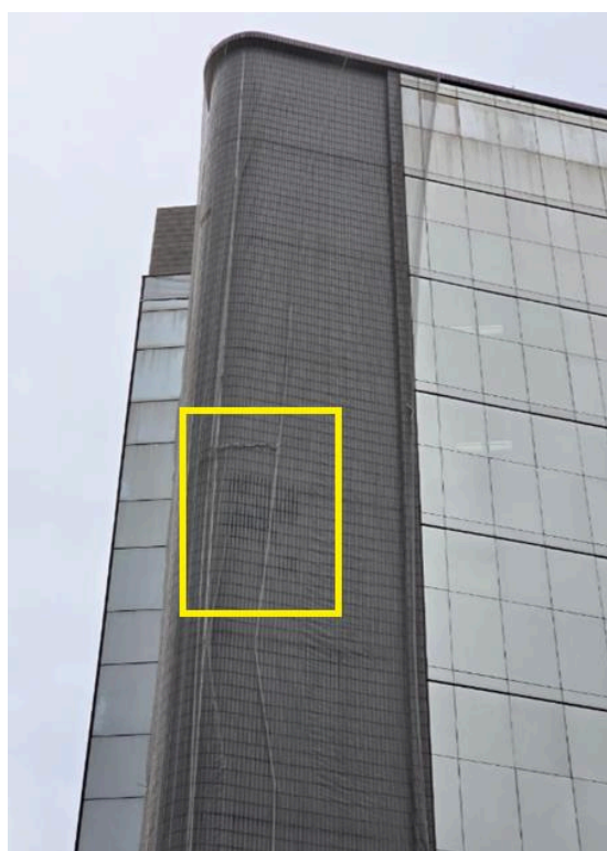
Figura 12 – Imagem ilustrativa destacando mancha de umidade no revestimento, a qual podemos notar fissuras e possível deslocamento da superfície apontada.
