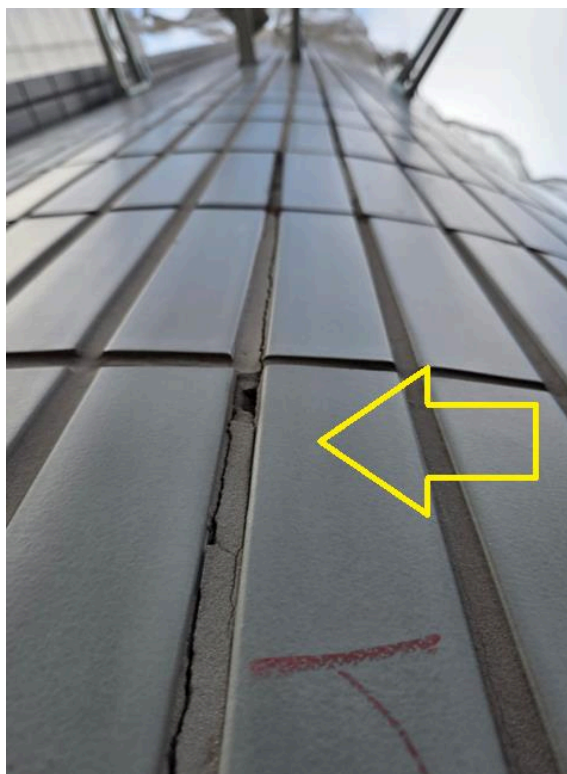
Figura 13 – Imagem ilustrativa destacando fissura vertical.
