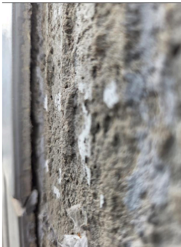
Figura 17 – Imagem ilustrativa destacando o descolamento do revestimento da fachada.
