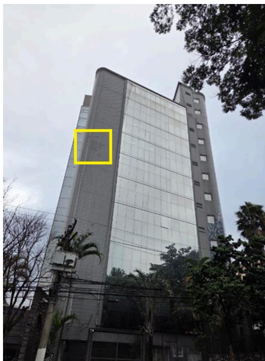
Figura 11 – Imagem ilustrativa destacando mancha de umidade no revestimento, a qual podemos notar fissuras e possível deslocamento da superfície apontada.
