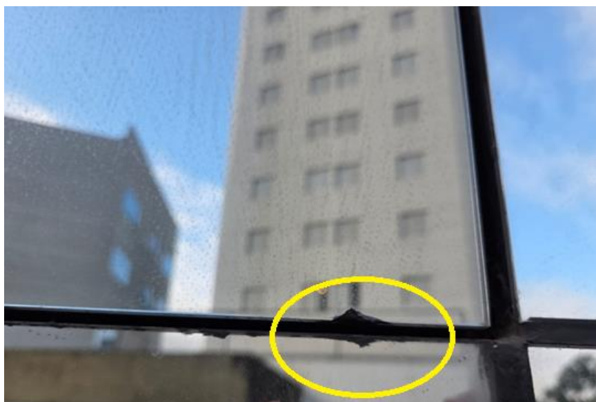
Figura 16 – Imagem ilustrativa destacando vidro quebrado.
