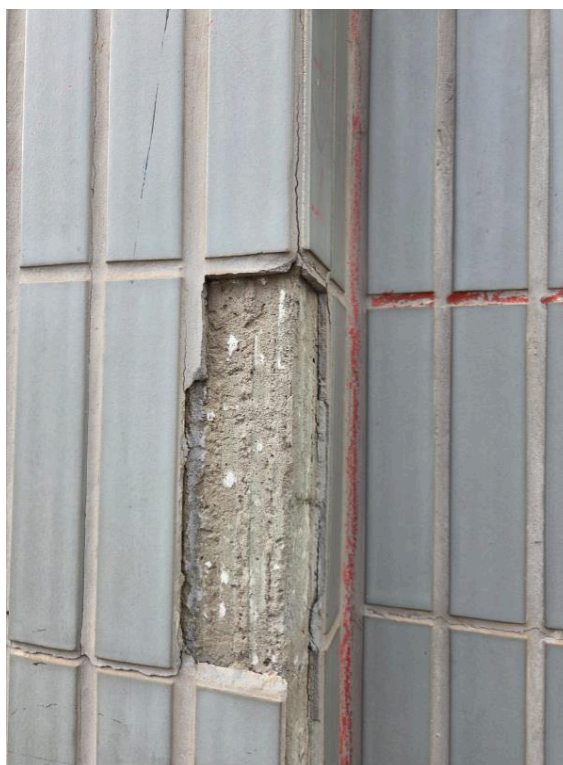
Figura 18 – Imagem ilustrativa destacando o revestimento descolado e fissura vertical.
