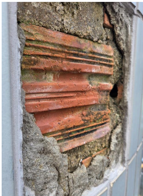
Figura 14 – Imagem ilustrativa destacando ausência de chapisco sobre o bloco.
